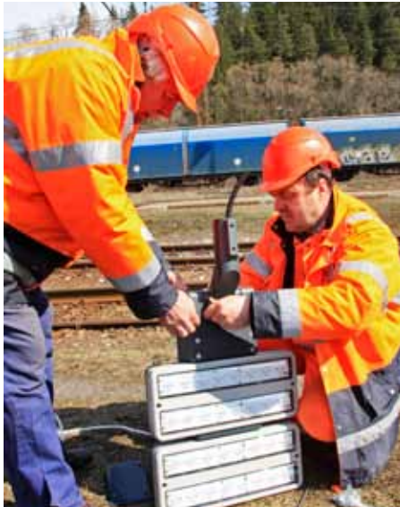
Elektromontéri z SMSÚ EE SZ Vrútky (zľava Pavol Groma a Jaroslav Chmúri) pripravujú LED svietidlo pred jeho montážou na osvetľovací stožiar.
