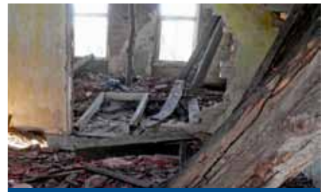
Vnútro stanice je v zúfalom stave.
