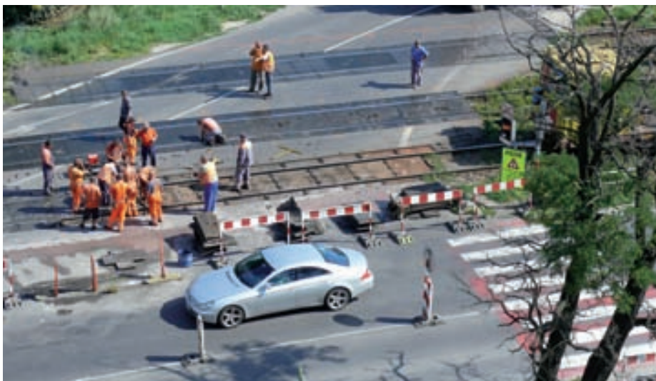
Priecestné zabezpečovacie zariadenie uviedli do prevádzky v roku 1963. Pôvodné bolo typu PZS 4Z so závorami. V rámci zdvojkolajnenia trate Bratislava - Nové Mesto - Bratislava ÚNS sa v roku 1976 sprevádzkovalo priecestné zabezpečovacie zariadenie typu PZS 2 bez závor.
