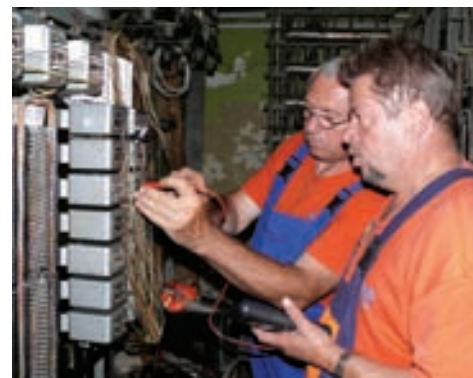
Peter Gaňa a Ján Podhorec z SMÚ OZT OT Žilina v káblovej miestnosti merajú a pripájajú telefónne linky do nového dispečerského systému.
