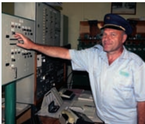
Elektromechanické staničné zabezpečovacie zariadenie bolo vypnuté, dočasne je v Melčiciach automatické hradlo AH2000. Ovláda ho aj Vladimír Vagač, výpravca vo funkcii hradlára.
