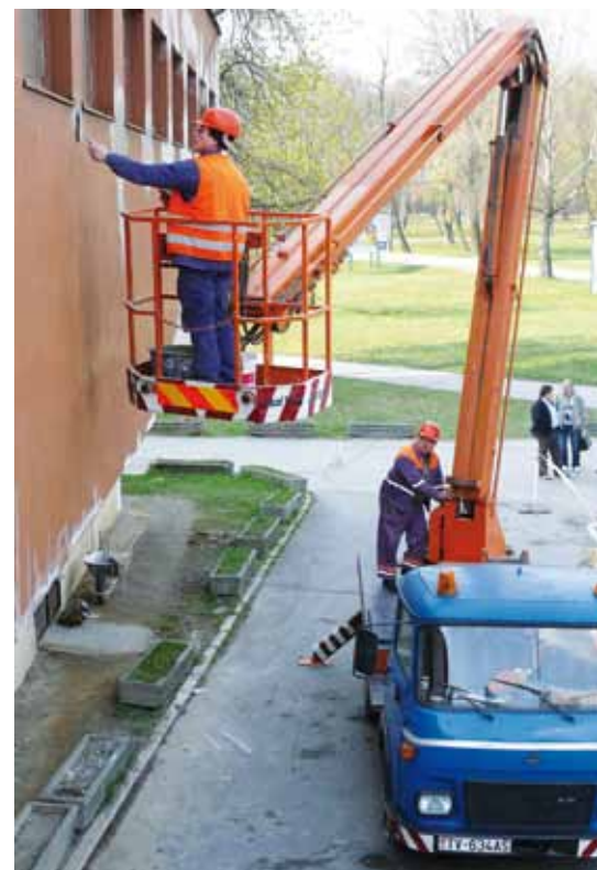
Fasáda staničnej budovy si vyžadovala murárske aj maliarske opravy.
