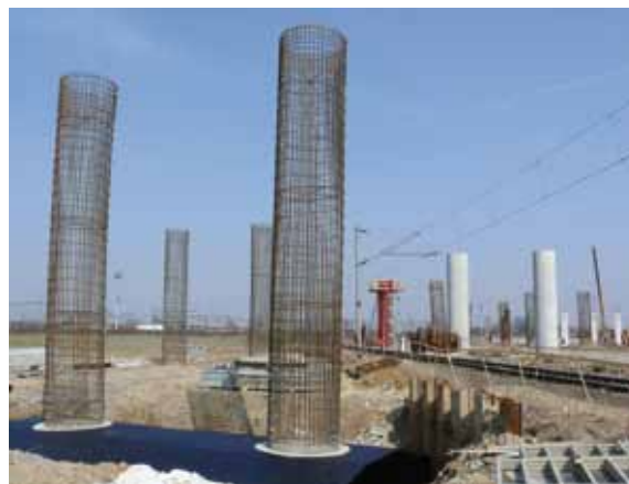
Výstavba pilierov cestného nadjazdu si vyžiadala aj vypnutie napätia v troleji spojovacej koľaje medzi stanicou normálneho rozchodu a depom. Po koľaji jazdia len vozidlá nezávislej trakcie.
