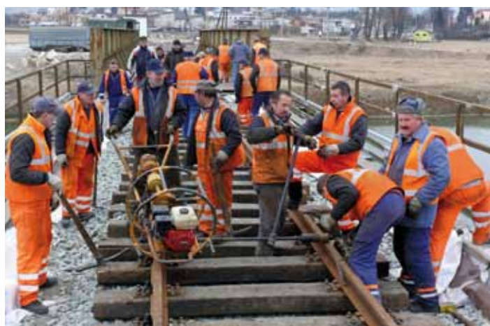
Na obnove odplaveného zemného telesa, navození štrku, ručnom rozložení podvalov a montáži koljaže sa podieľali traťoví robotníci z SMÚ ŽTS TO Margecany.
