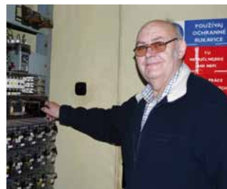
Vojtech Kollár, vedúci prevádzky SMÚ OZT ZT Nové Zámky, stlačením hlavného vypínača umlčal reléovku a zhasol svetlá návěstidiel.
