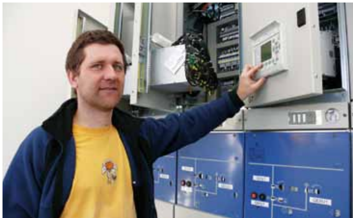
Ing. Roman Frič, koordinátor SMS EE ET Liptovský Mikuláš, predvádza miestne ovládanie novej rozvodne na manipulačnom paneli ochrany.
