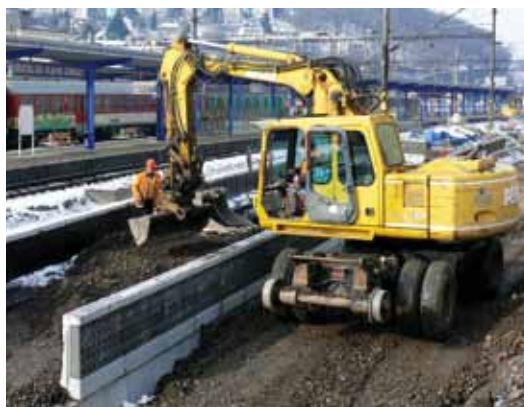
Stavbu, ktorá má byť odovzdaná v apríli 2011, realizuje spoločnosť Železničné stavebníctvo Bratislava, a. s.
