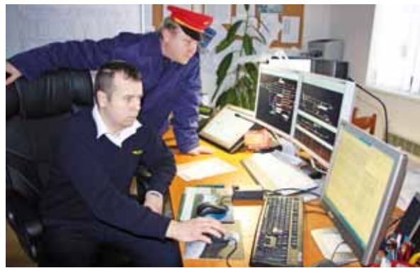
V dopravnej kancelárii v Kysaku majú všetky riadené smeru pod kontrolou. Pomocou ovládacieho panelu dá výpravca príkaz na stavadlo, kde ho riadiace zariadenie vyhodnotí a postaví vlakovú cestu v požadovanom smere. Všetko to výpravcovia vidia v „priamom prenose“. Na fotografii dispozičný výpravca Miroslav Hriciščák a vonkajší Peter Čeklovský.
