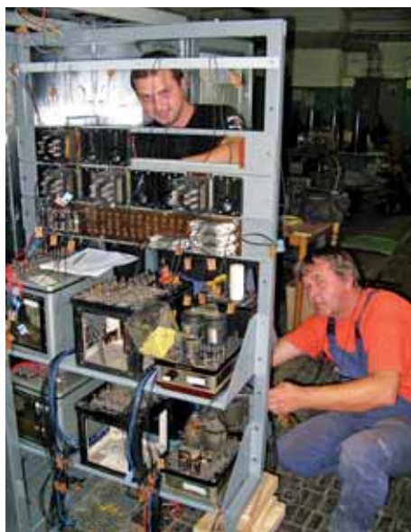
Elektrické rozvody pre relé autobloku v dielni pripravujú majster OZT Jozef Bednárík a elektromechanik Milan Záh (za stojanom).
