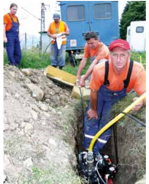
Jediný zafukovací prístroj v ŽSR, pridelený SMÚ OZT KT Nové Zámky, obsluhuje návestní majster Tibor Szabó (vpravo), za ním mu asistuje kolega Jozef Csatay, vľavo sleduje prácu vedúci prevádzky Martin Štubendek, všetci z novozámockého pracoviska. Kábel pripravuje aj Jozef Beňo (druhý zľava) z SMÚ OZT KT Žilina.
