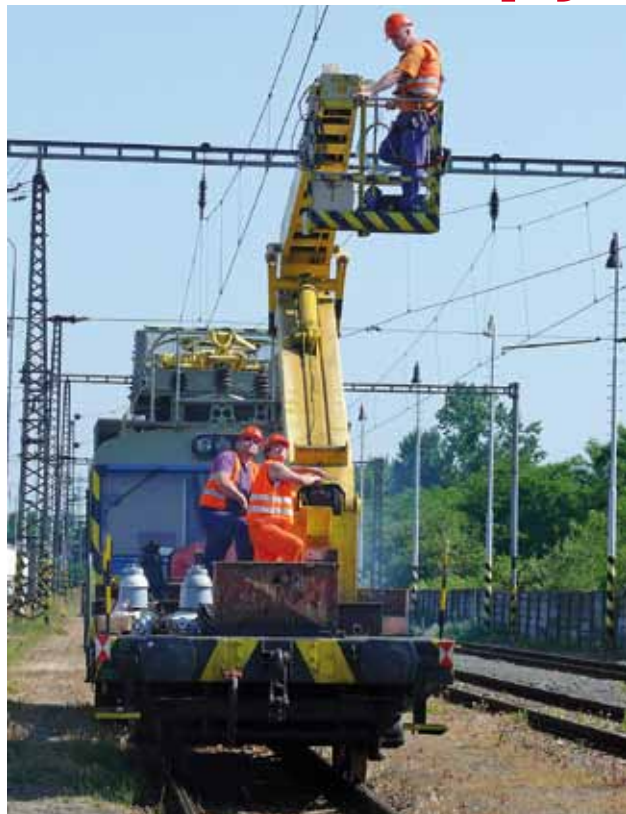
Pri manipulácii s plošinou elektromontéri sledovali aj polohu trakčného vedenia, aby nedošlo k jeho poškodeniu.
