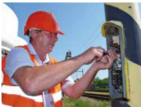
Údržbu stožiarovej rozvodnice vykonáva elektromontér Jozef Macek.
