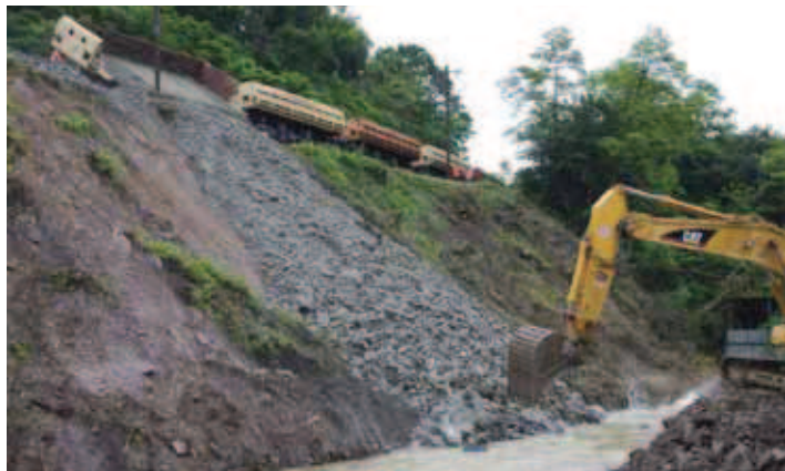
Zemina na svahu pod traťou sa v dôsledku vytrvalých dažďov zosypala do rieky Svinka, no zosúvajúci sa svah upevnili štrky a kamene.
