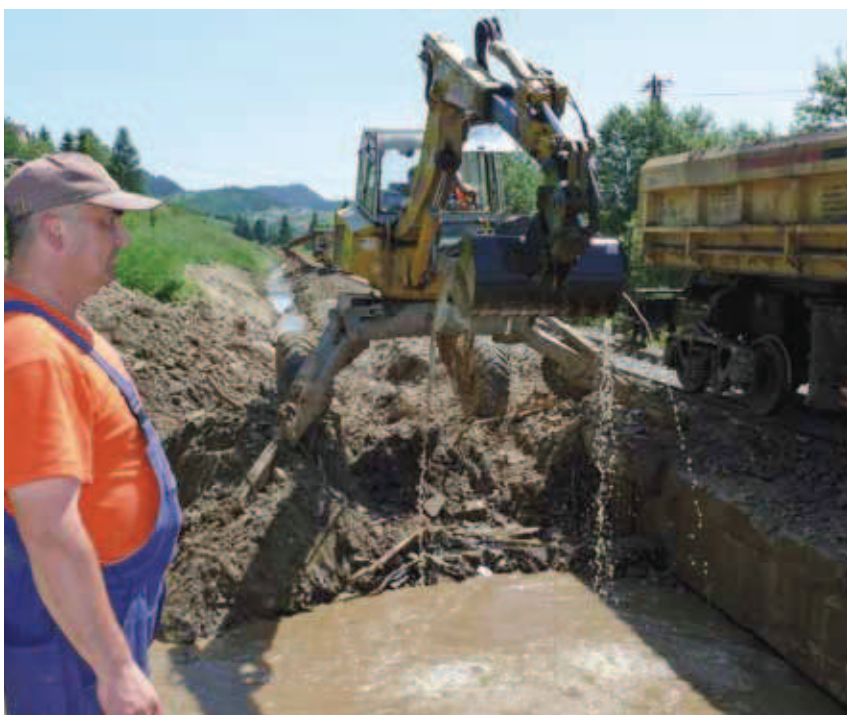
Čistenie zaneseného priepustu a koryta potoka sťažoval najmä náročný terén, s ktorým si poradilo len „kráčajúce“ rýpadlo Menzi Muck privezené z externého prostredia. Ján Kanuščák, majster z SMÚ ŽTS TO Prešov, s uznaním sleduje zručnosť strojníka pri ovládaní rýpadla, ktoré za pár hodín vyfažilo takmer 100 kubíkov naplavenín.
