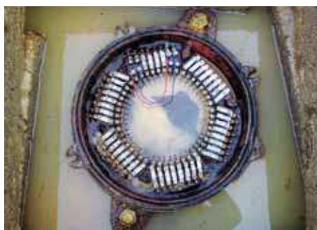
Nebezpečenstvo zásahu elektrickým prúdom hrozilo zo zaplavených elektrických rozvádzačov.
