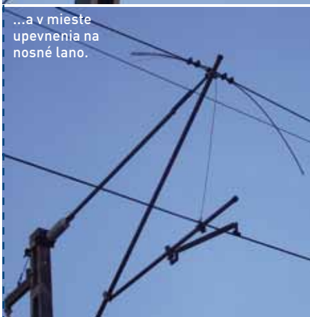
Odstríhnuté lano pevného bodu od izolátora na ukotvenej trakčnej podpere...
