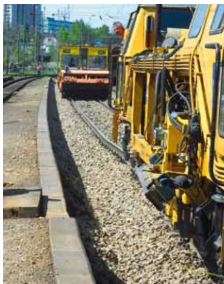
Úprava geometrickej polohy koľaje sa nezaobíde bez strojnej podbijačky a pracovného stroja PUŠL.
