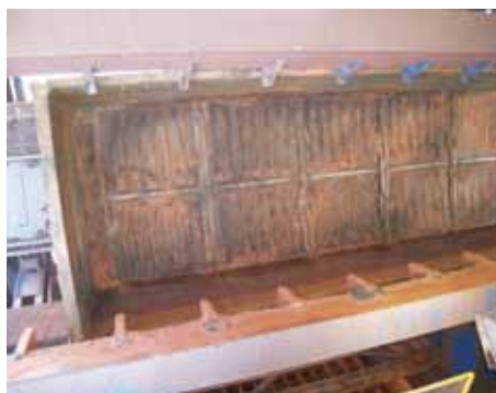
Rotačný výklopník vyklápa vozne ŠR otočením o 175° okolo ich pozdĺžnej osi, čím dôjde k vysypaniu substrátu cez rošt do štyroch zásobníkov. Nad roštom sú umiestnené dve frézy, ktoré v zimnom období rozrušia zamrznutú hruď substrátu na rošte.
