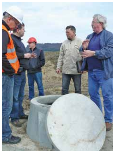
Sprava Ing. Ivan Pisko z projektovnej firmy PRODEX a Ing. Peter Novák zo Strediska prípravy a realizácie Žilina spoločne so zástupcami dodávateľov riešia stav kanalizačného zberača.
