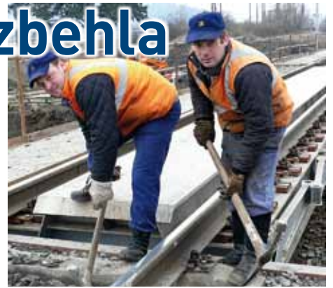
Traťoví robotníci Štefan Gorek a Roman Korienek (zľava) z SMÚ TO Trenčín vykonávajú úpravu výškovej polohy prevádzkovej traťovej koľaje po pokládke mostného provizória.
