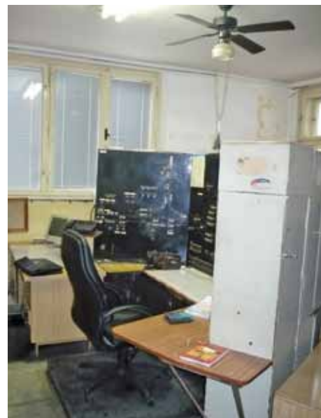
Pracovisko dispozičného výpravcu na reléovom zabezpečovacom zariadení v Kysaku.
