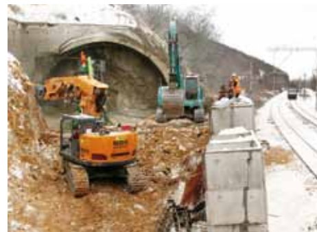
Výrub v hornej časti južného portálu do mierne zvetraného vápence je zabezpečený dvojradovým mikropilóťovým dáždnikom a striekaným betónom. Budovanie 22 m vysokej zárubnej steny v ťažko prístupnom svahu sa deje v tesnej blízkosti jestvujúcej železničnej trate.
