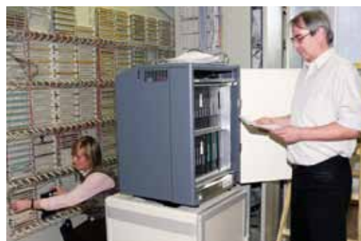
Ing. Petra Zgeburu (vpravo), vedúceho skupiny hlavovej techniky, sme zastihli pri kontrole konfigurácie novej ústredne. Jozefína Ľubeková, technička telekomunikačnej techniky, zasa pripravuje rozvoje elektrických vodičov na prepínanie telefónnych účastníkov.
