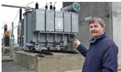
-Nové transformátory sú už uložené na betonových monolitoch zastrešeného stanovišťa, – ukazuje Stanislav Ľukovič zo sekcie EE, OR Trnava.
