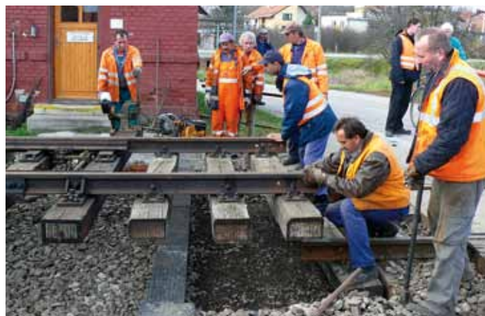
Posledná výmenová časť výhybky sa vymeriavala a pokladala opatrne, aby sa podvalmi nepoškodila šachta drôtovodu odchodového návěstidla.
