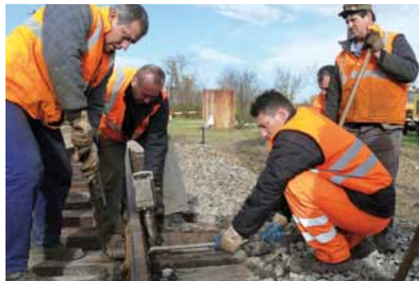
Po položení srdcovkovej časti koľajovým žeraviom ju s výmenovou časťou predchádzajúcej výhybky spájajú (zľava) Miroslav Chmelan, Jozef Halmo a Peter Žember, ich činnosť sledujú kolegovia z traťového obvodu Ladislav Száraz a Ľudovít Belán.
