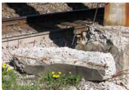
Až tento obrovský vypadnutý kus betónu do koľajiska nenechal zodpovedných chladnými. O dva dni rozhodli o rekonštrukcii mosta, postupo i termínoch.
