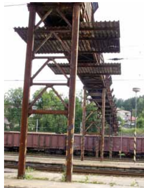
Aj lávka pre chodcov ponad koľajisko je v zlom stave. Demontovať túto konštrukciu bude tvrdým orieškom.
