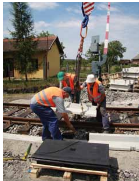
Montáž novej priecestnej konštrukcie Cepak zabezpečila firma BRS, zamestnancov ktorej sme zachytili pri ukladaní betónových prefabrikátov na betónový základ nového priecestia.
