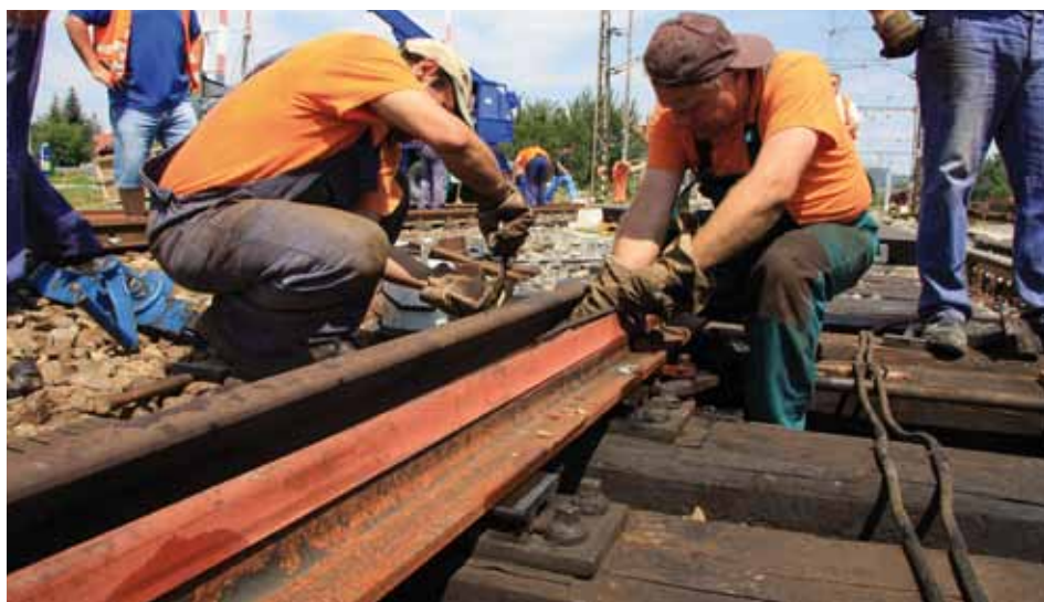
Železničné priecestie v objekte stanice Kozárovce prešlo koncom júla komplexnou rekonštrukciou. Jej súčasťou bola aj výmena podvalov, jazykov a oporníc vo výhybkách. Reguláciu hákového záveru po výmene jazyka a opornice zabezpečovali zamestnanci SMÚ TO Levice.
