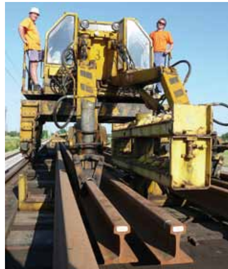
Strojníci Vladimír Romančík a Dušan Lojdl (zľava) na portálovom manipulátore sa starajú o správny a presný prísun koľajnicových pásov, alebo ramenami manipulátora pomáhajú pri vyťahovaní inventárnych koľajnic.
