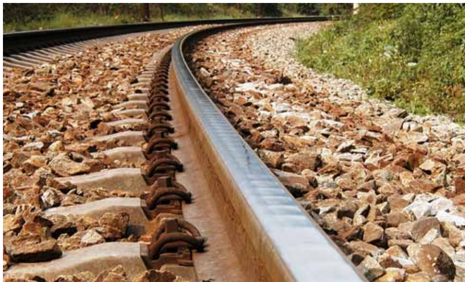
Až v takomto rozsahu sa prejavovala vlnkovitosť koľajníc napríklad aj v úseku Kysak – Drienovská Nová Ves. V oblúkoch s malým polomerom sa vyskytuje len na vnútornom koľajnicovom páse.
