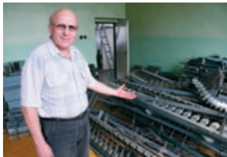
- Pred 13. marcom to boli ešte funkčné stojany, plné linkových voličov, triedičov či skupinárov, - ukazuje na kopy šrotu Štefan Galko, technik telekomunikačných zariadení.
