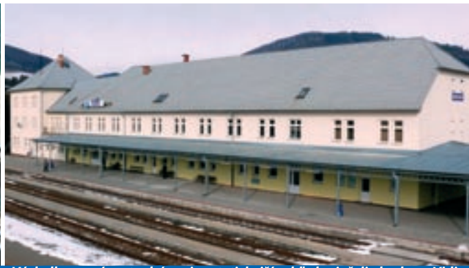
Výsledkom práce stavbárov je esteticejší vzhľad priečelia budovy. Viditeľná je najmä murovaná nadstavba pre kancelárske priestory.
