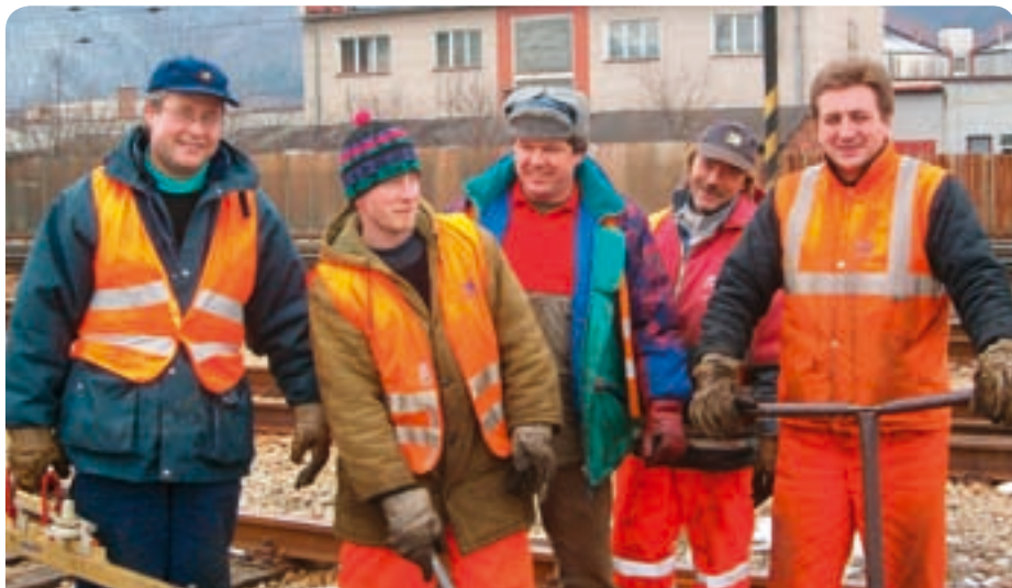
Zámočníci koľajových konštrukcií na čele s majstrom Jaroslavom Vaškom (prvý zľava) v železničnej stanici Vrútky – osobná stanica odstraňujú poruchy vo výhybkách a koľajniciach.
