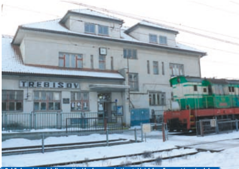
Pohľad na sivé priečelie staničnej budovy znechutí cestujúcich hneď po vystúpení z vlaku.
