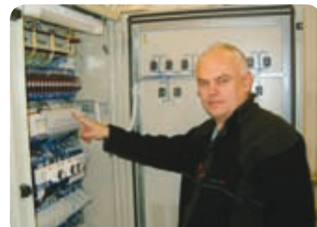
Kvôli novému dispečerskému stavadlu Simis – W v prízemných priestoroch stanice zrekonštruovali niekoľko miestností. Technický chod zabezpečuje návestný majster Jozef Nitka.
