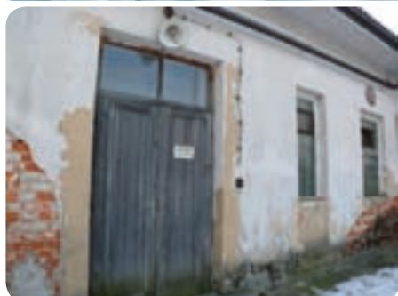
Plesnivé a opadané múry budovy už akútne potrebujú novú fasádu.
