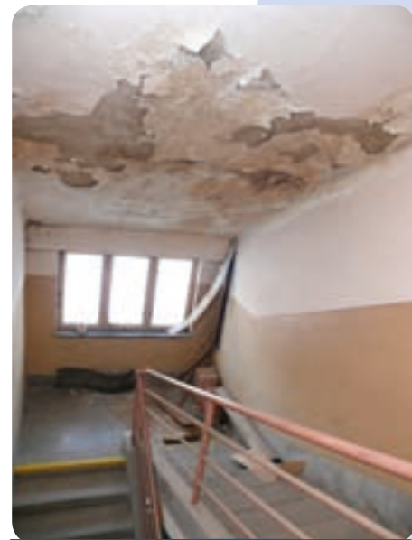
Strop na schodišti márne čaká na maliarov.
