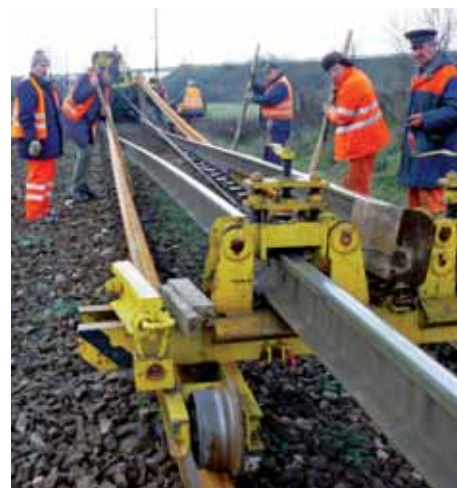
Pri skladaní 25-metrových koľajnicových pásov zo súpravy SDK II na betónové podvaly asistovali traťoví údržbári z úseku Jána Sleziača, vedúceho prevádzky SMÚ ŽTS TO Liptovský Mikuláš.
