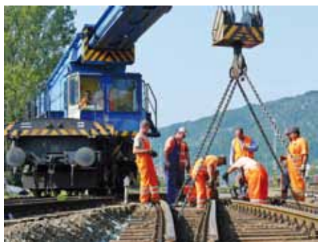
Presne položené diely spojky už rutinne pospájajú traťováci z SMÚ ŽTS TO Košice pod vedením Jána Molnára, vedúceho úseku prevádzky Plešivec.
