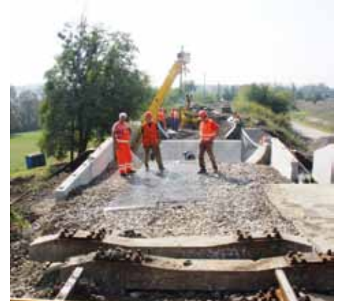
Súčasťou tretej etapy výstavby nového mosta vo Veľatoch bola úprava železničného zvršku na použitie koľajových žeriavov.
