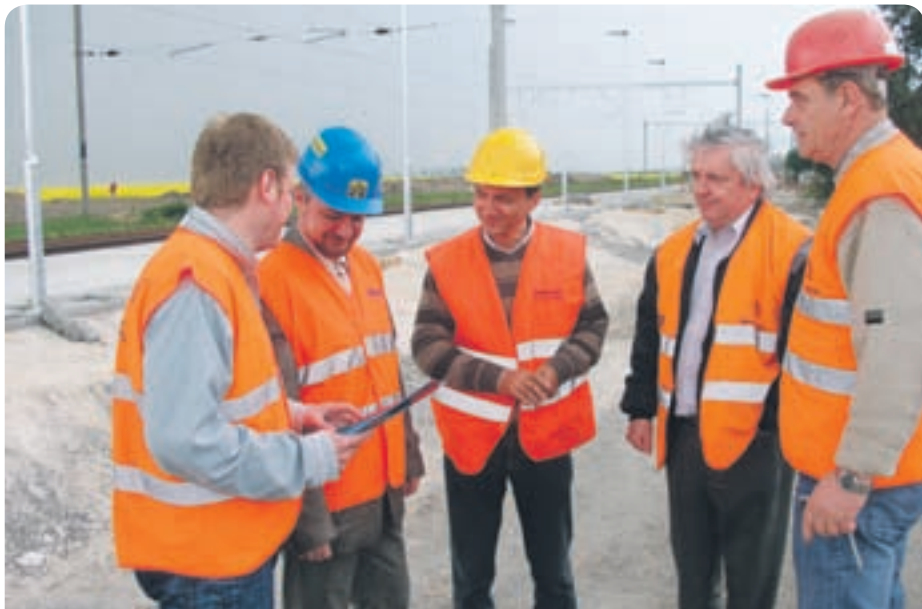
Zastávka Brunovce „žiarí“ novotou, ale vysoké pracovné tempo si žiada aj previerku dodržiavania zásad bezpečnosti pri práci. Pri kontrole sme práve zastihli za ŽSR zľava Ing. Mariána Tkáča, ale aj Klaudia Jančoviča, Miroslava Kohúta, obaja za Združenie SK – Nové Mesto a za zhotoviteľov Ing. Juraja Zvolenského a Jána Málika. Obidvaja za Združenie Geotechnika – SGS.
