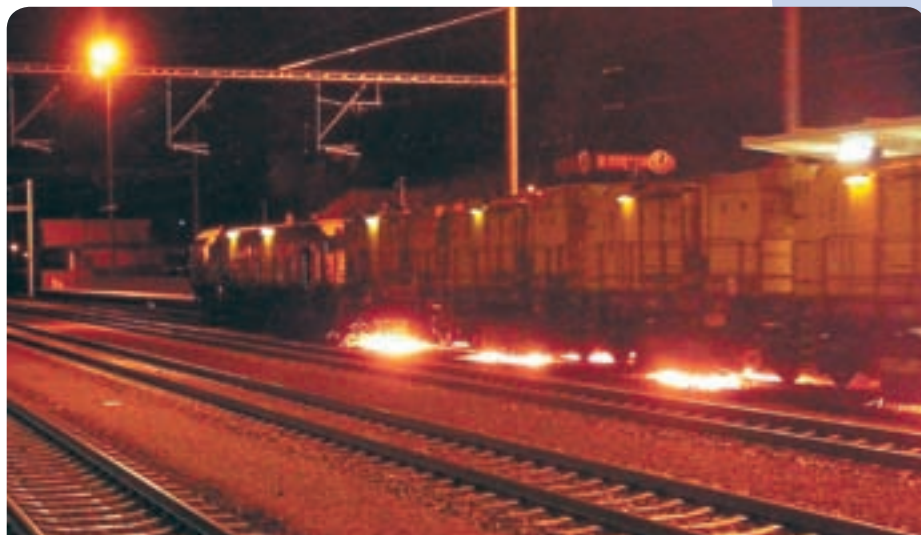
Brúsenie koľajníc sa realizovalo počas nočných výluk jednotlivých traťových a staničných koľají. Dĺžky výluk sa pohybovali v rozsahu 6 hodín.
