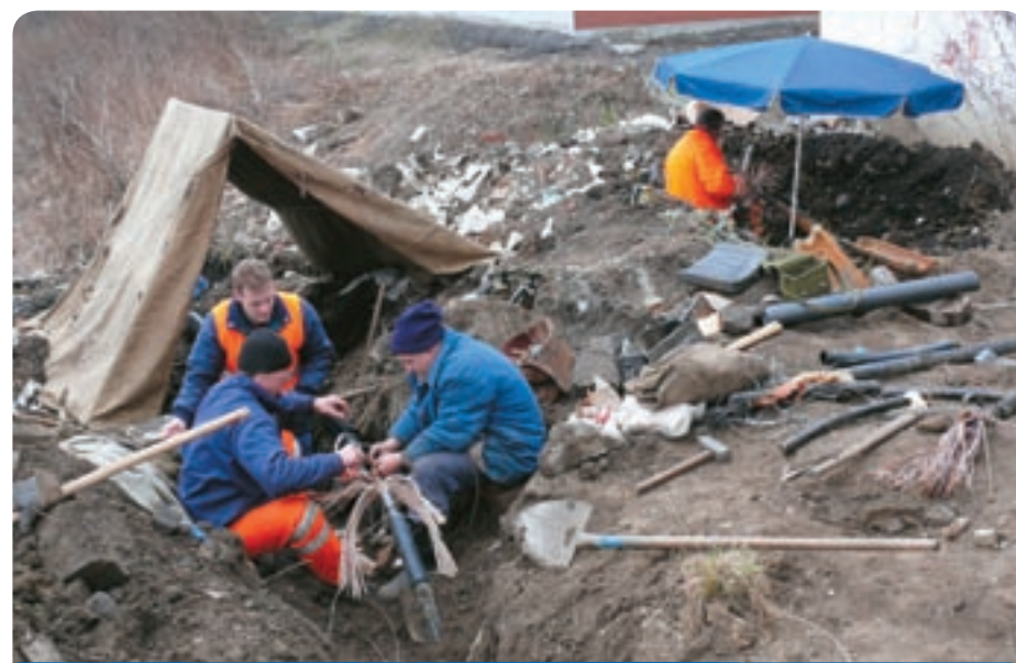
Tak toto nie je piknik, ale náročná práca kabeľárov počas výmeny stometrového úseku kábla.
