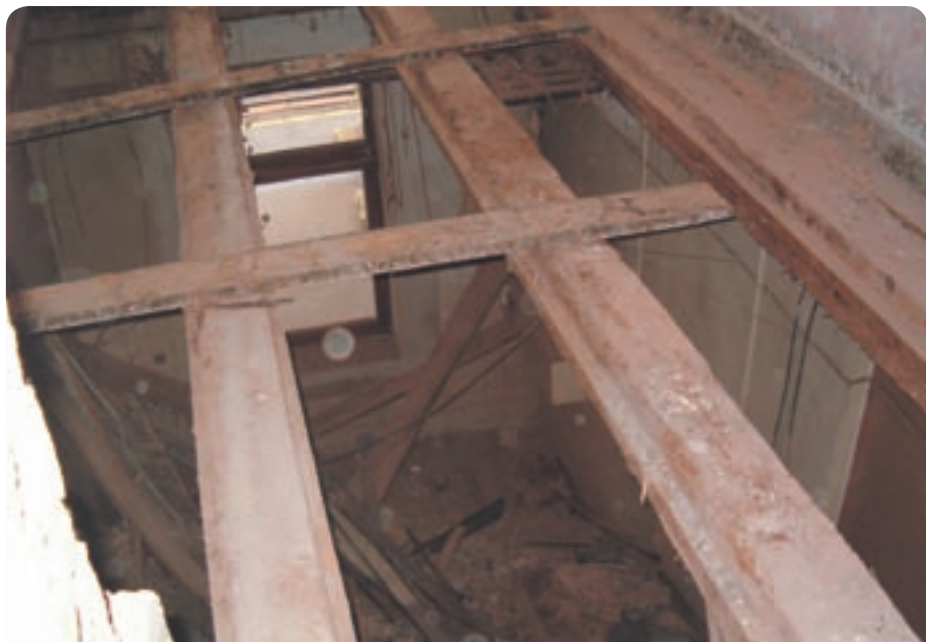
Poschodie s oddeleným vstupom, raz bude slúžiť Atrakčnému obvodu, pre traťovákov, elektrikárov a ďalšie profesie. Jedna z miestností je zatiaľ v takomto stave.
