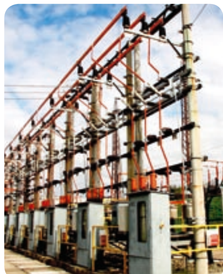
Na modernizáciu rozvodne sa použili technologické zariadenia rozvodne PASS od firmy ABB.
