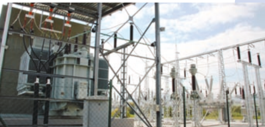
Akákoľvek neschopnosť prenosu energie cez rozvodňu 110 kV TM Kuzmice by spôsobila, že značná časť juhovýchodného Slovenska by sa ocitla bez elektriny.
