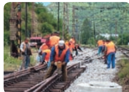
Železničiarškim slangom sa tomuto pracovnému výkonu hovorí „zaštrkovanie“ výhybky po pokládke zamestnancami SMÚ ŽTS TO Vrútky, pracovisko Kraľovany.
