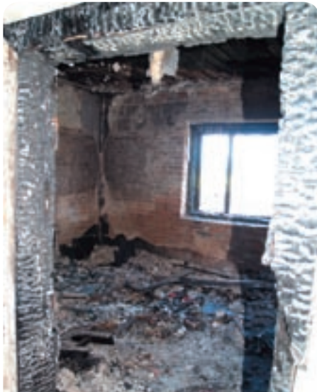
Vnútro rodinného domu ostalo takmer celé nepoužiteľné...
