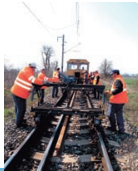
Práce počas výluky na trati Michalany – Trebišov, na medzistaničnom úseku Úpor – Trebišov, zabezpečovali zamestnanci z SMÚ TO Trebišov, pracoviska Michalany. Aj na fotografií na obálke.
