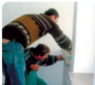
V suteréne staničnej budovy, murári firmy Gala, s.r.o pripravujú miestnosť, ktorá bude slúžiť pre nové zabezpečovacie zariadenie SIMIS W.
