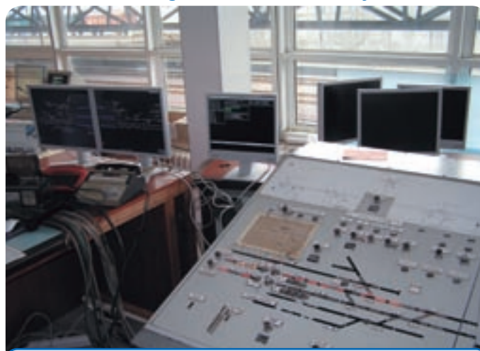
Staré zabezpečovacie zariadenie v dočasnej symbióze s novým.
