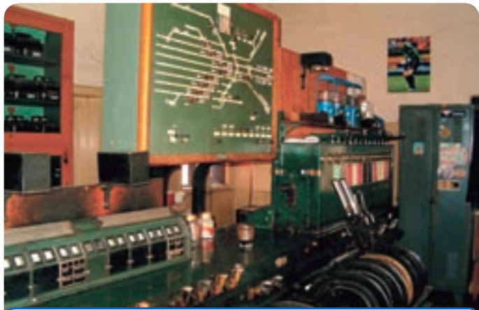
V Piešťanoch na stavadle 2 funguje toto elektromechanické zariadenie od roku 1938.
