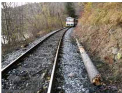
Spadnutý strom v úseku Nižná – Podbiel.
