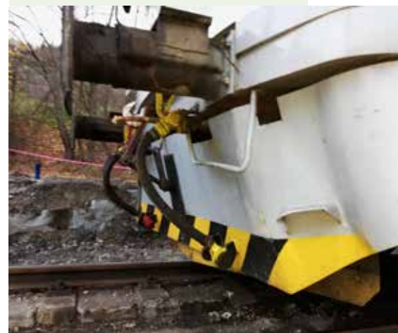
Poškodený vzduchový ventil Os 7914 (ZSSK) v dôsledku spadnutého stromu v úseku Nižná – Podbiel.
