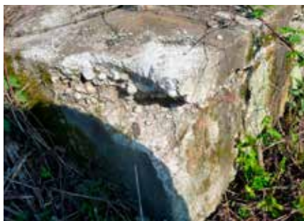
Stav základov pred rekonštrukciou.
