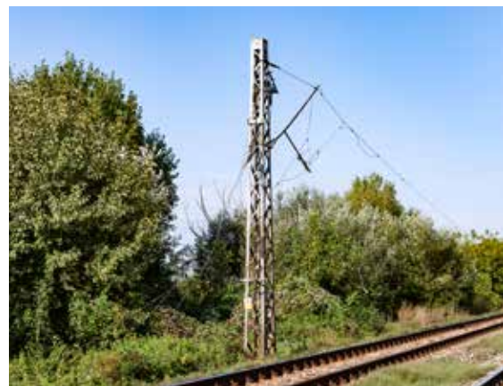
Rozsiahle poškodenie trakčného vedenia.
