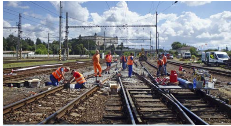
Všetky výhybky sú zvarené a izolované styky sú lepené na mieste.
