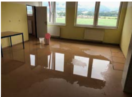
Prívalový dážď nemal pre chýbajúcu strechu žiadnu prekážku a voda zaplavila dve poschodia.
