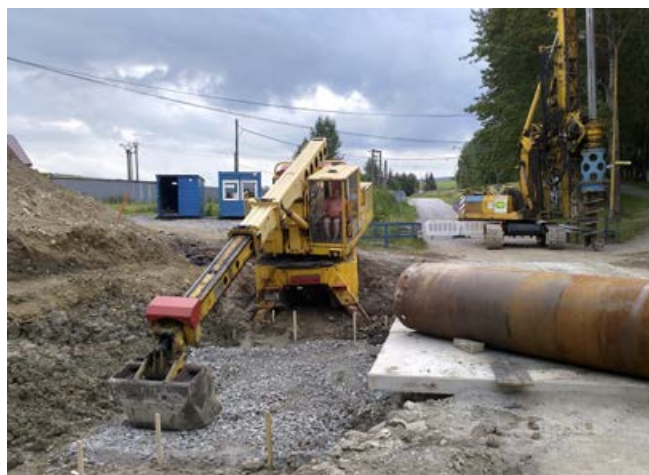
Na začiatku výluky sa vykonali aj prípravné práce pre realizáciu pilotov vrtnou súpravou.
