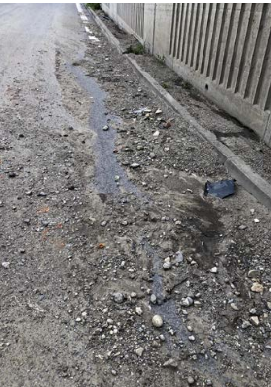
Podjazd bol dokončený riadne a včas už pred piatimi rokmi. Dnes je tam vážne poškodený aj asfalt vozovky.
