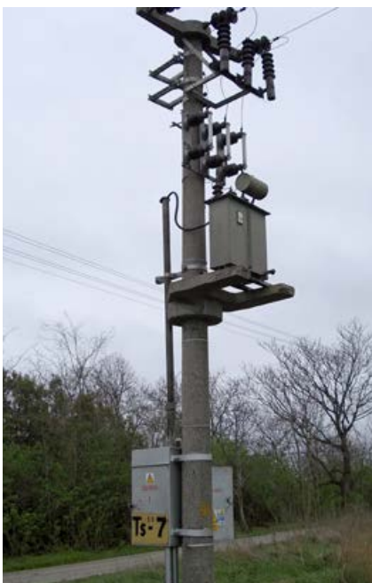
Transformačná stanica stožiarové, stĺpové, mrežové
