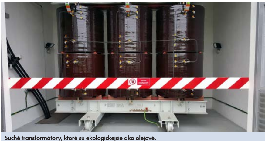
Suché transformátory, ktoré sú ekologickjšie ako olejové.
