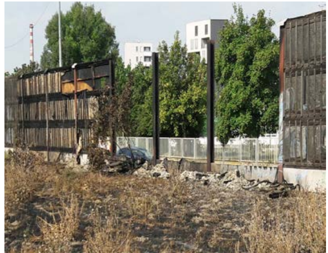
Zhoršená protihluková stena v úseku Bratislava-Petržalka – Bratislava ústredná nákladná stanica.
