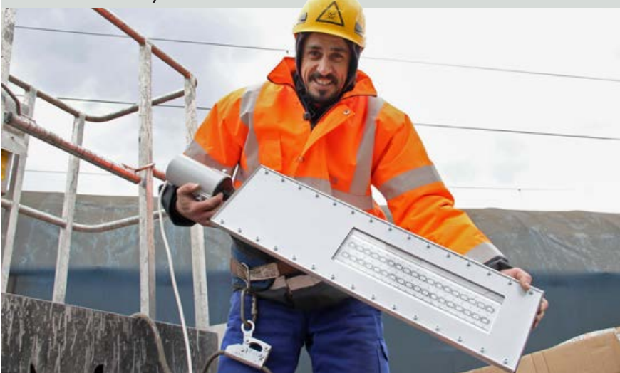
Novobudované zariadenia vonkajšieho osvetlenia s úspornými svetelnými LED zdrojmi s vysokou životnosťou a minimálnymi nárokmi na údržbu.
