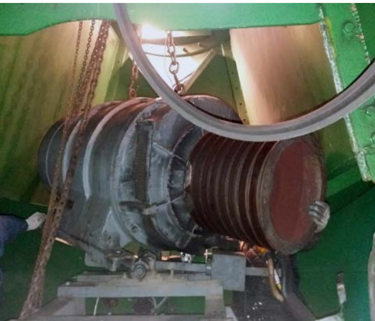
Rozobratý motor ventilátora, kde sa zistila porucha ložísk, čo bolo príčinou odstavenia z prevádzky.
